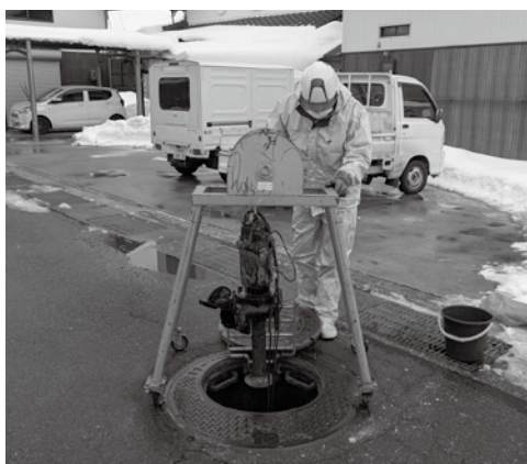
ポンプが詰まると引き上げて修理が必要
