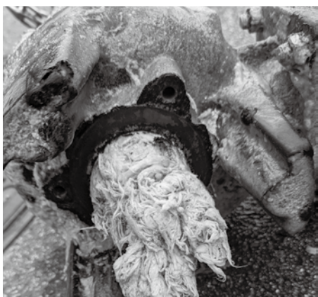
詰まるとポンプを分解して修理が必要
