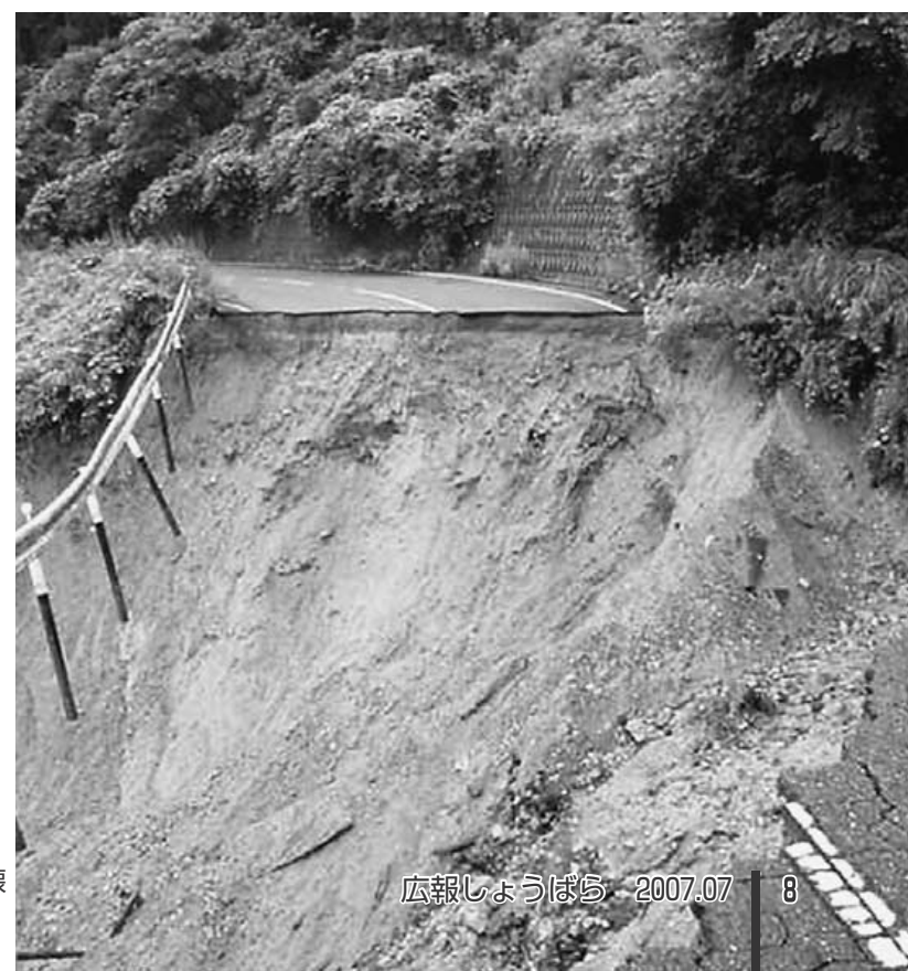
口和では大規模林道が崩壊
