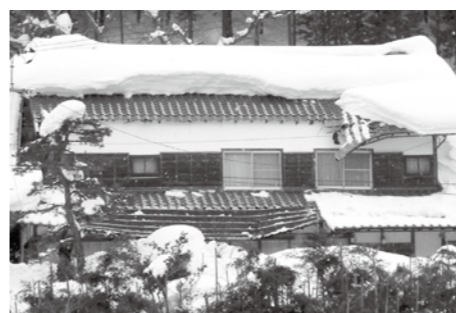
雪の重みで損壊した民家の屋根(西城地域)
