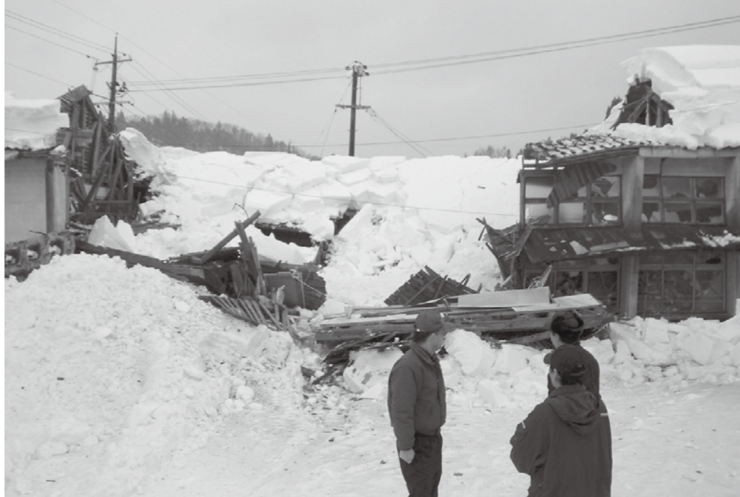
2階建ての倉庫が積もった雪で全壊(高野地域)
