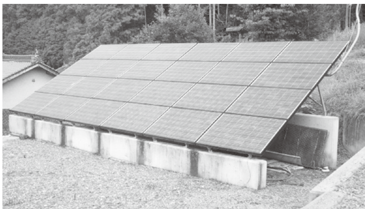
太陽光発電システム
