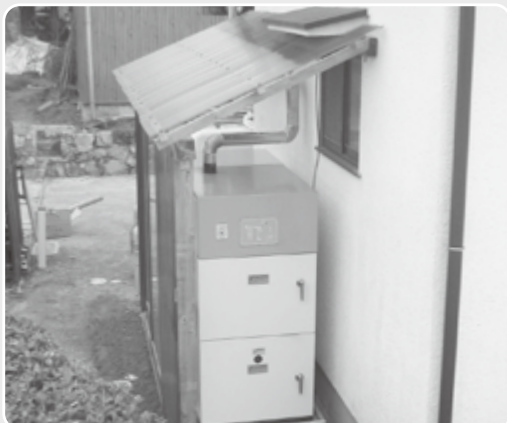
家庭に設置されたペレットボイラー
