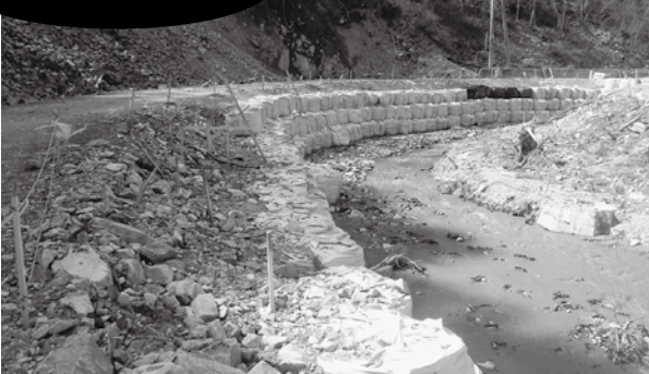
被災後仮復旧状況
