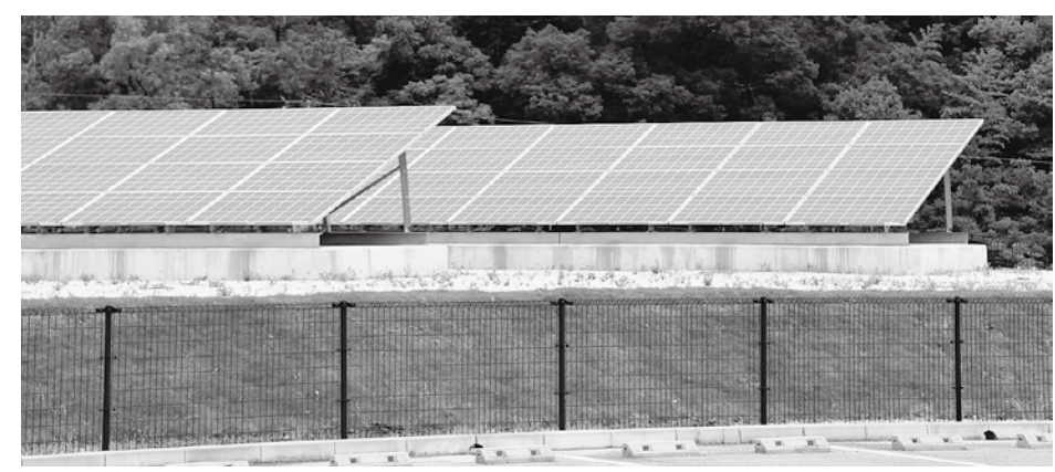
リサイクルプラザに設置の太陽光パネル
