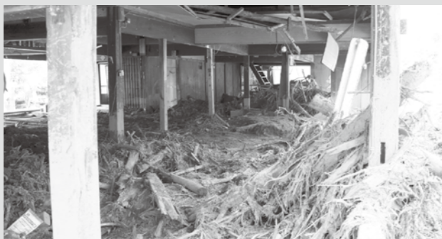
空家のため手付かずになっている隣家の状況
