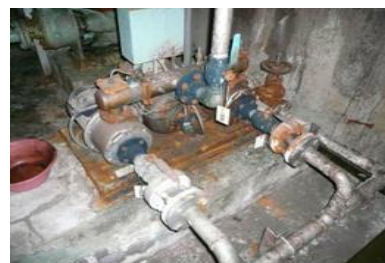
し尿処理施設の設備状況
