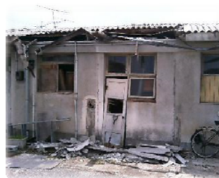
適正管理されていない空き家の一例
