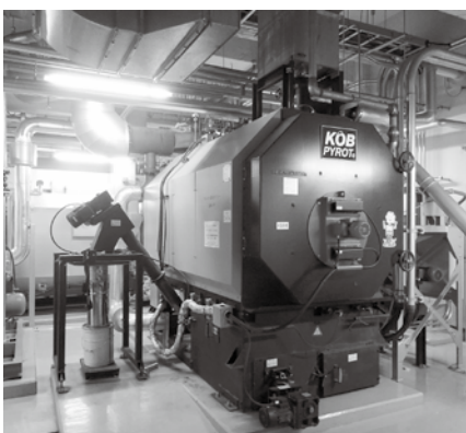
市庁舎のペレットボイラー
