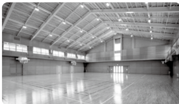
LED照明を設置した屋内運動場
