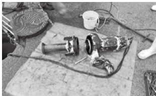
詰まると分解・修理が必要
