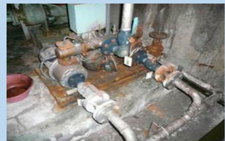
し尿処理施設の設備状況
