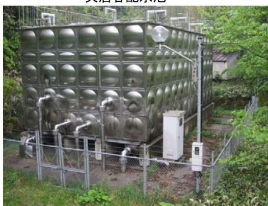
比和簡易水道 配水池
