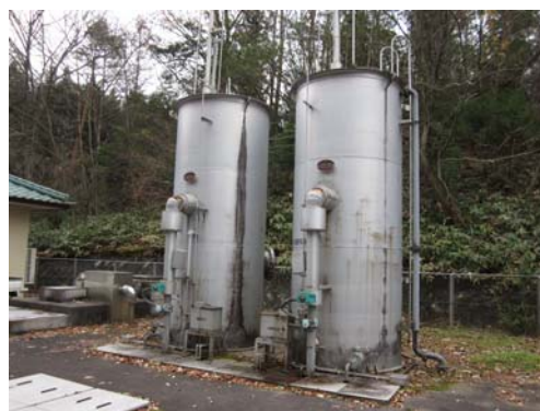
向泉浄水場（急速ろ過機）
