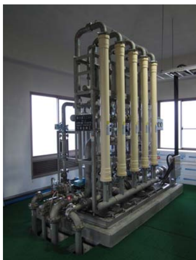
膜ろ過浄水場（膜モジュール）
