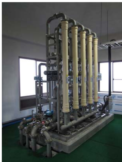
膜ろ過浄水場（膜モジュール）
