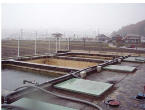
新市浄水場（緩速ろ過池）
