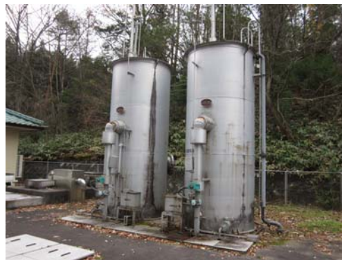
向泉浄水場（急速ろ過機）
